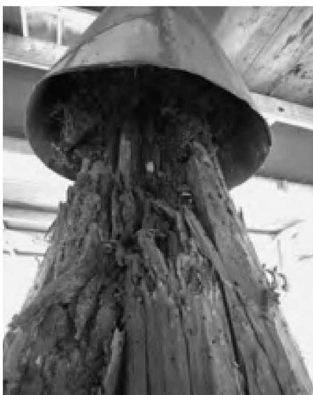
Charpente du clocher avant restauration
