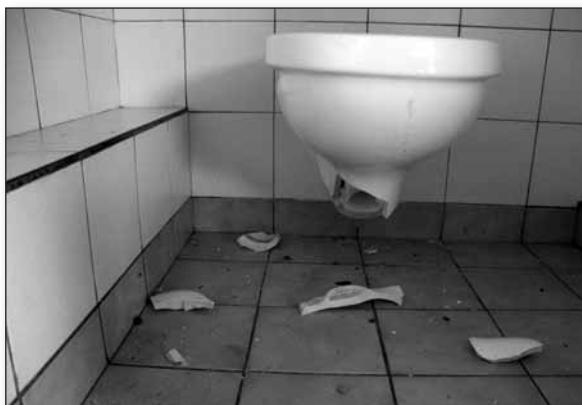
WC Sud Parc de l'Arabie: vandalisme
