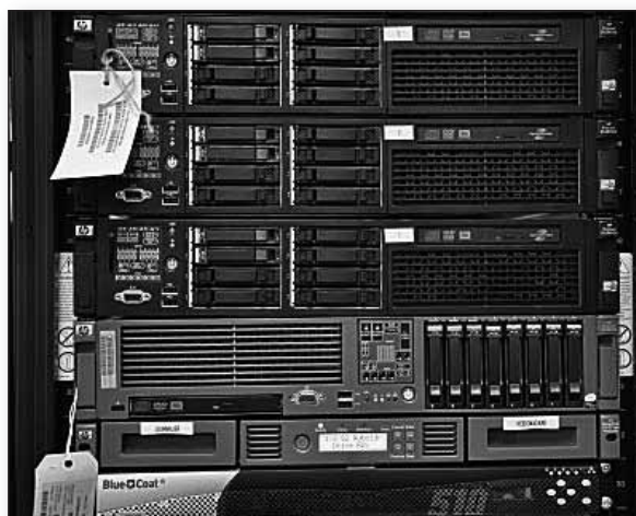
De bas en haut, les trois nouveaux serveurs physiques, un ancien serveur pilotant les sauvegardes (backup), la librairie de bandes LTO4* et le serveur de proxy*.
