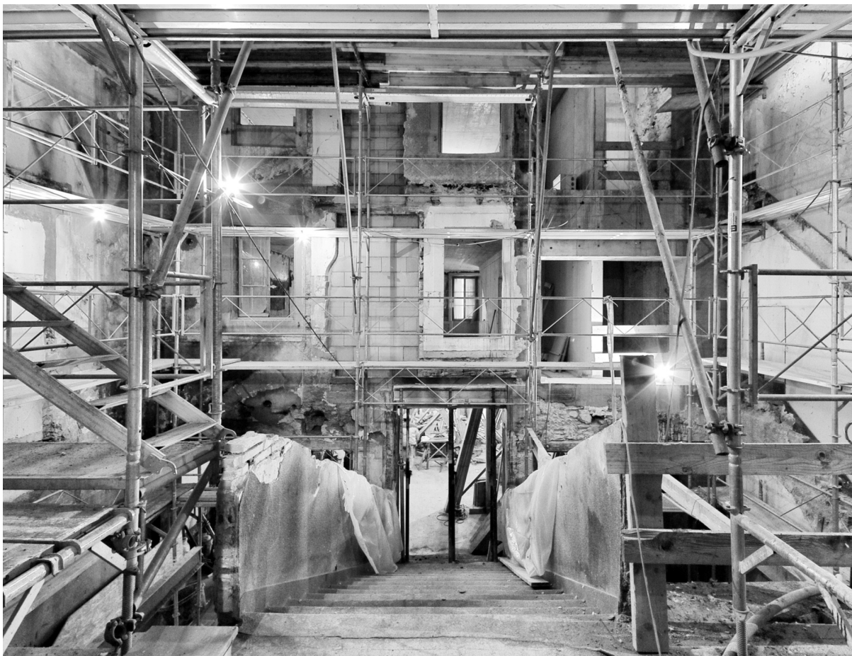
Le chantier de l'Oriental arrive au terme de la phase du gros œuvre.
