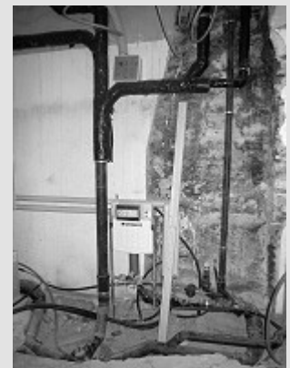
Installations techniques sanitaires
