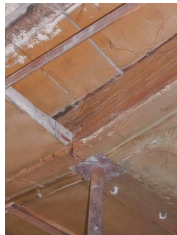
Poutre cassée au premier étage
