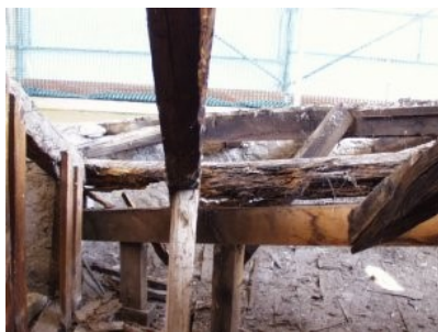
Découverte de la charpente pourrie
