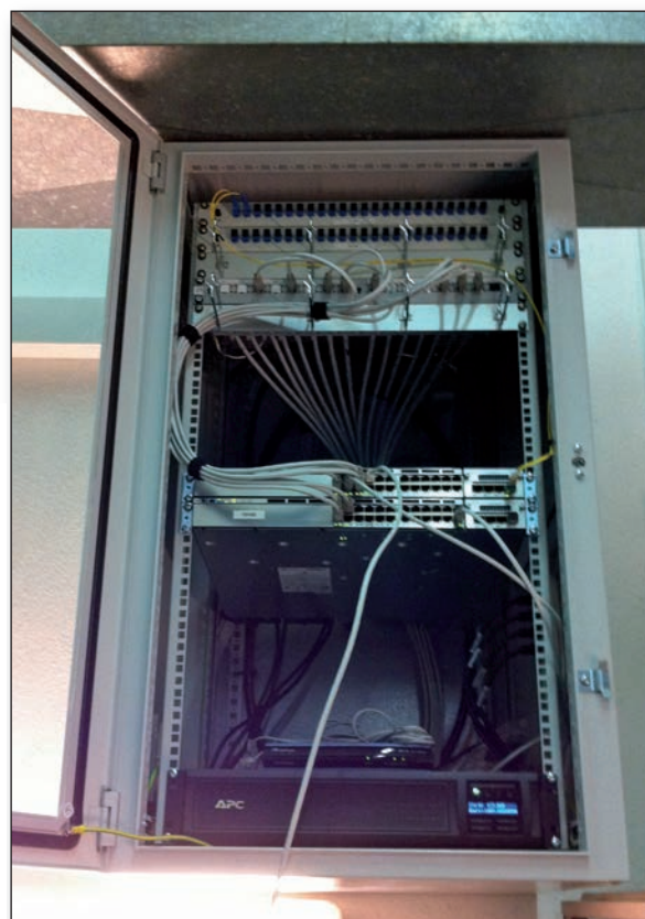
Armoire de brassage à la voirie
